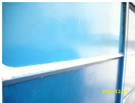
Abbildung 175: Wasserabweisende Farbbeschichtung (stabil nach 9 Monaten).
